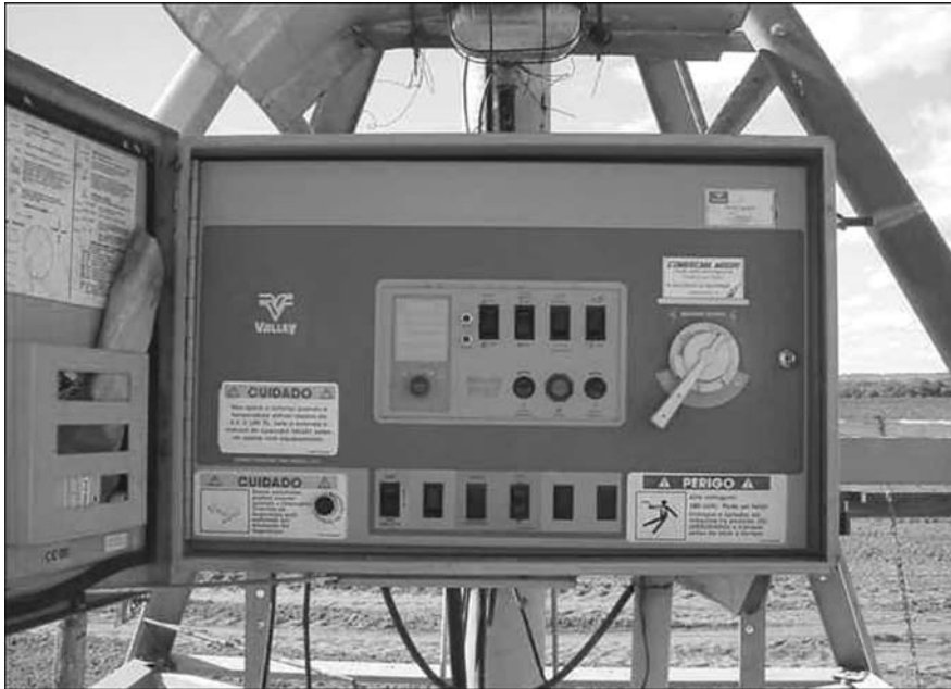
Figura 28. Painel de controle de um pivô central Valley.
