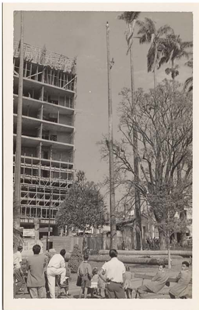
Fig. 118 - Obra do Itatiaia mostrando claramente ausência de vigas nas lajes do andar tipo, resultado do uso do sistema "caixão perdido". Fonte: Coleção MIS 1323 - Acervo Museu da Imagem e do Som de Campinas - 1954.
