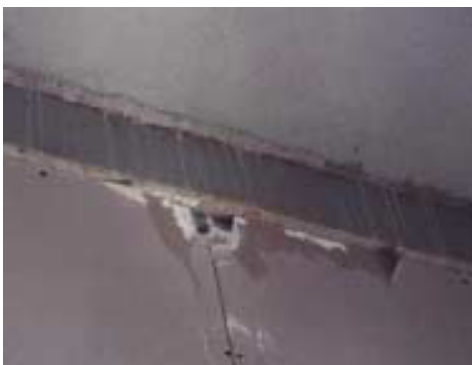
FIGURA 4.23 – Danos causados pela umidade nas placas de gesso
