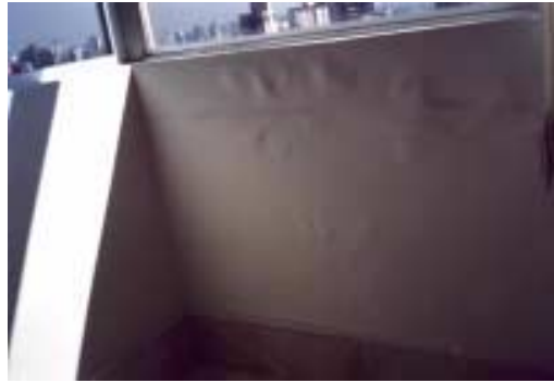
FIGURA 4.27 – Infiltração nas vedações de fachada
