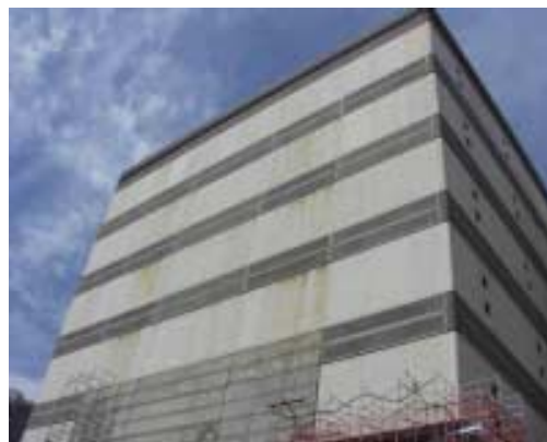
FIGURA 4.68 – Manchas de ferrugem na fachada
