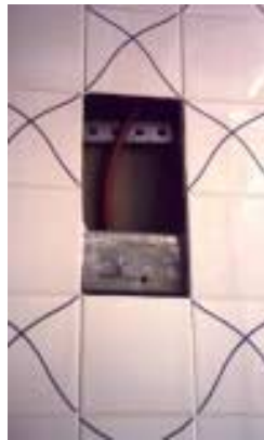
FIGURA 4.40 – Facilidade de manutenção
