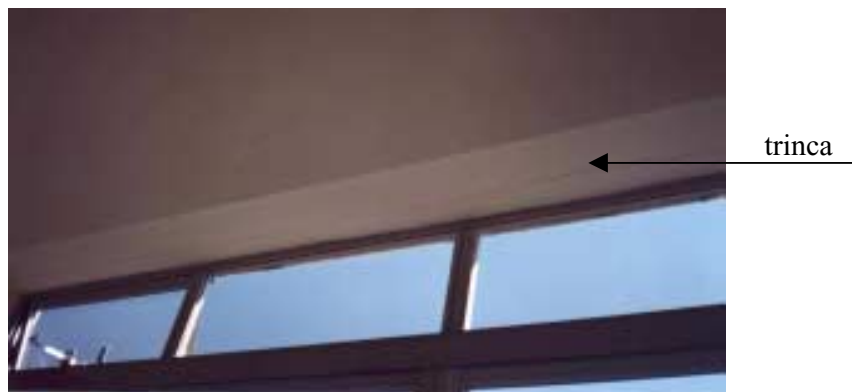
FIGURA 4.28 – Trincas na verga/esquadria
