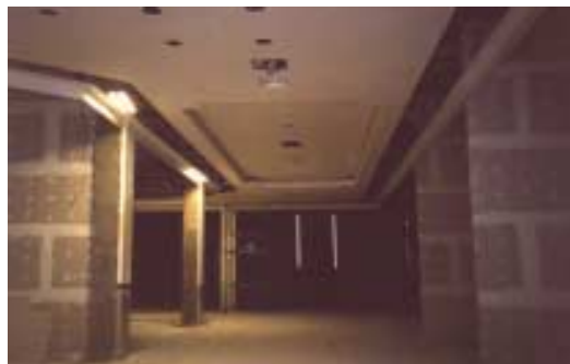
FIGURA 4.66 – Vista geral da montagem de divisórias de gesso acartonado
