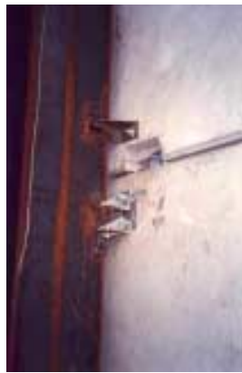
FIGURA 4.67 – Reforço na ligação entre pilar e painel de fachada
